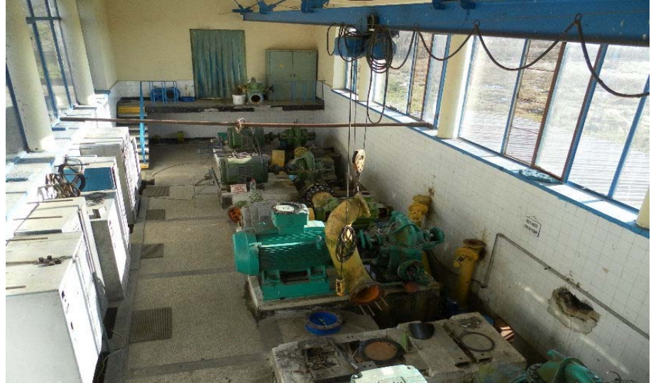
Station de Pompage à Dobritch
