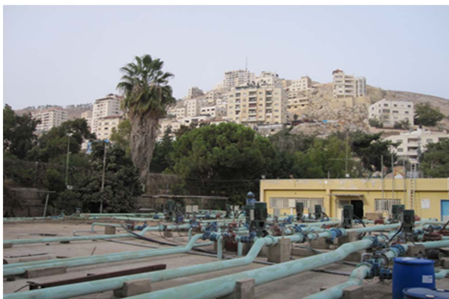
Station de Pompage Principale à Naplouse
