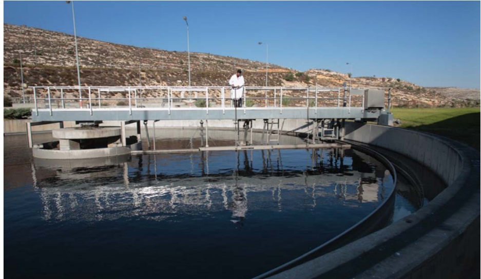
Kläranlage - Nachreinigung durch Sedimentation
