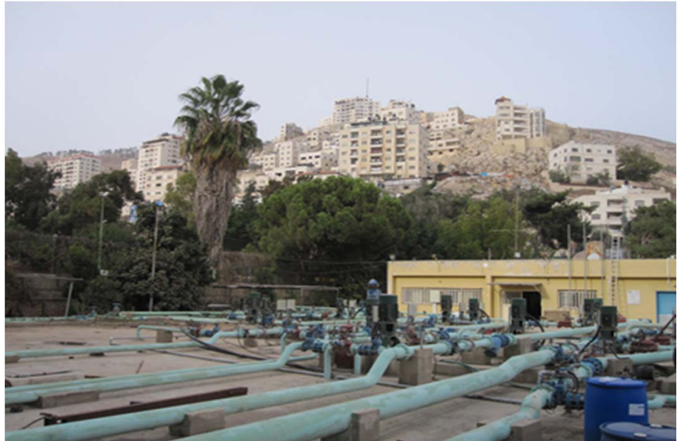
Hauptpumpwerk in Nablus
